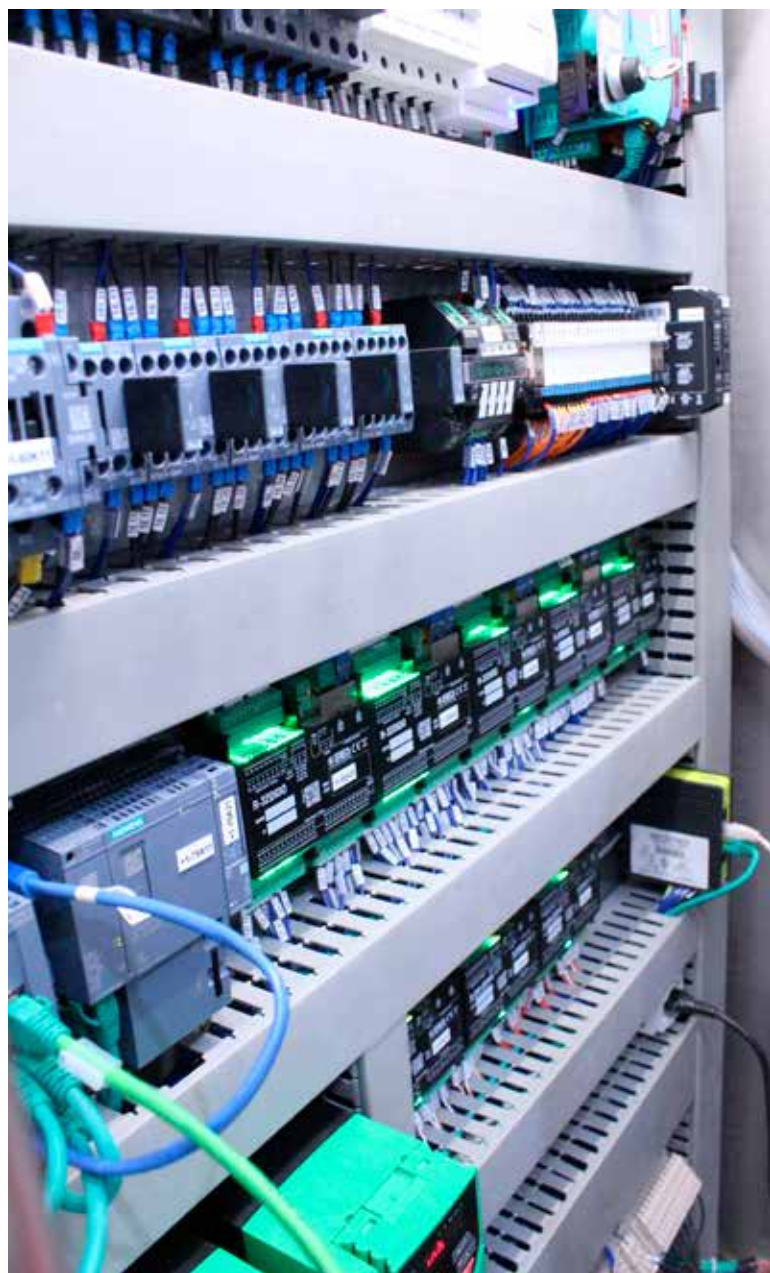
Un quadro elettrico nuovo può allungare la vita operativa di un impianto senza cambiare i macchinari, permettendo di fornire gli stessi prodotti che hanno reso famosa un'azienda
