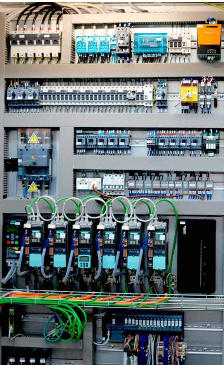
Le nuove componenti installate con un retrofiting permettono di produrre come prima, ma in meno tempo, usando quindi meno energia durante la giornata
